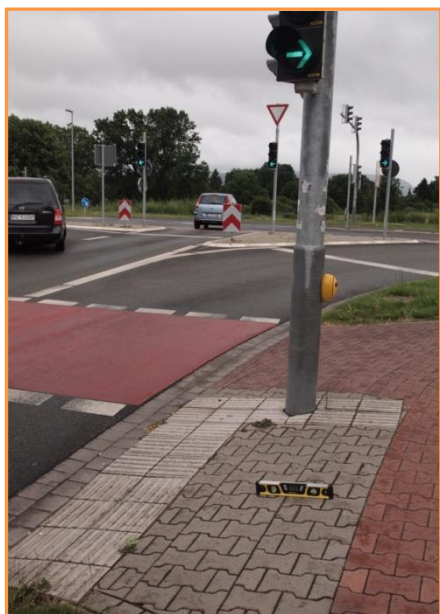
Abbildung 43: Starke Neigung Kaiserstraße an der Ecke Hafenstraße
